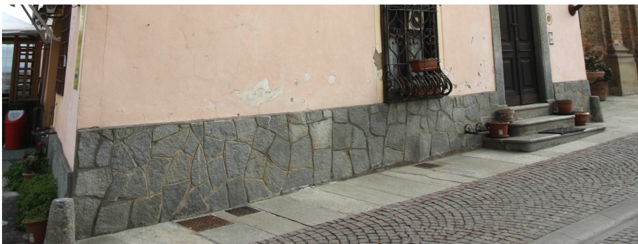
Esempio di zoccolo in opus incertum da sostituire.
