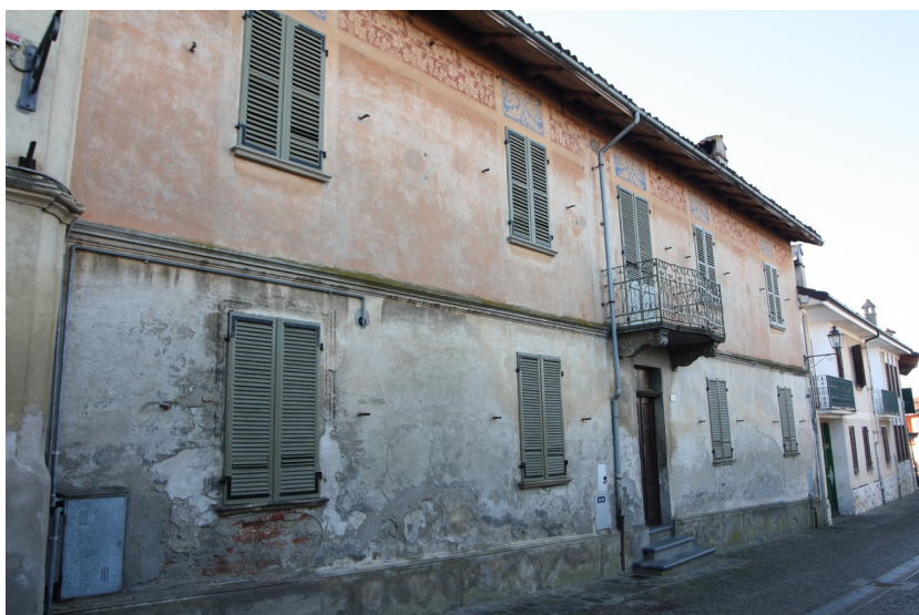
Fascia con decoro policromo sotto lo sbalzo della copertura. Elemento decorativo di pregio da restaurare.
