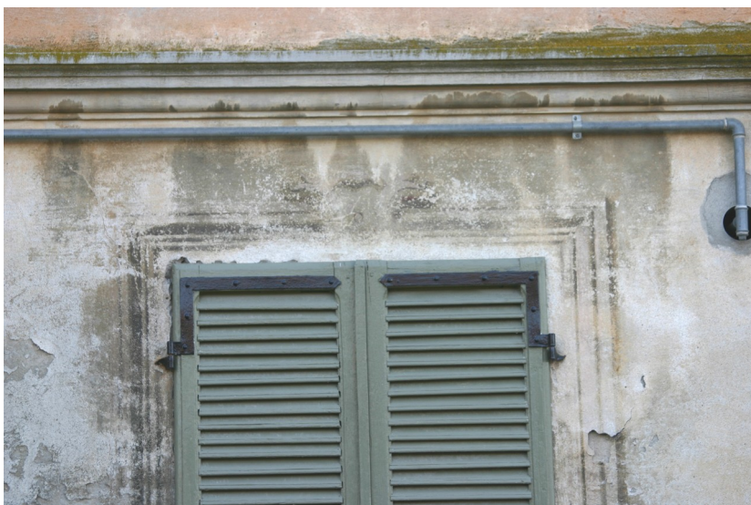
Cornice eseguita con la tecnica del trompe l'oeil da conservare e restaurare.
